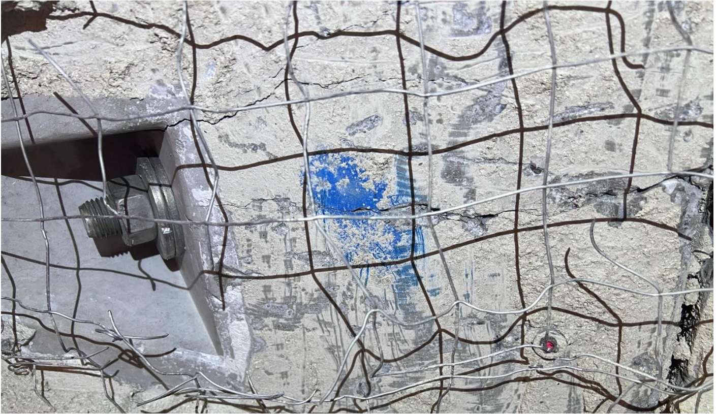
Figuur 4 Detail van een boutpocket met scheurvorming zichtbaar. Het wapeningsgaas is onderdeel van de laag de hittewerende bekleding (die is wegehaald voor het onderzoek).
