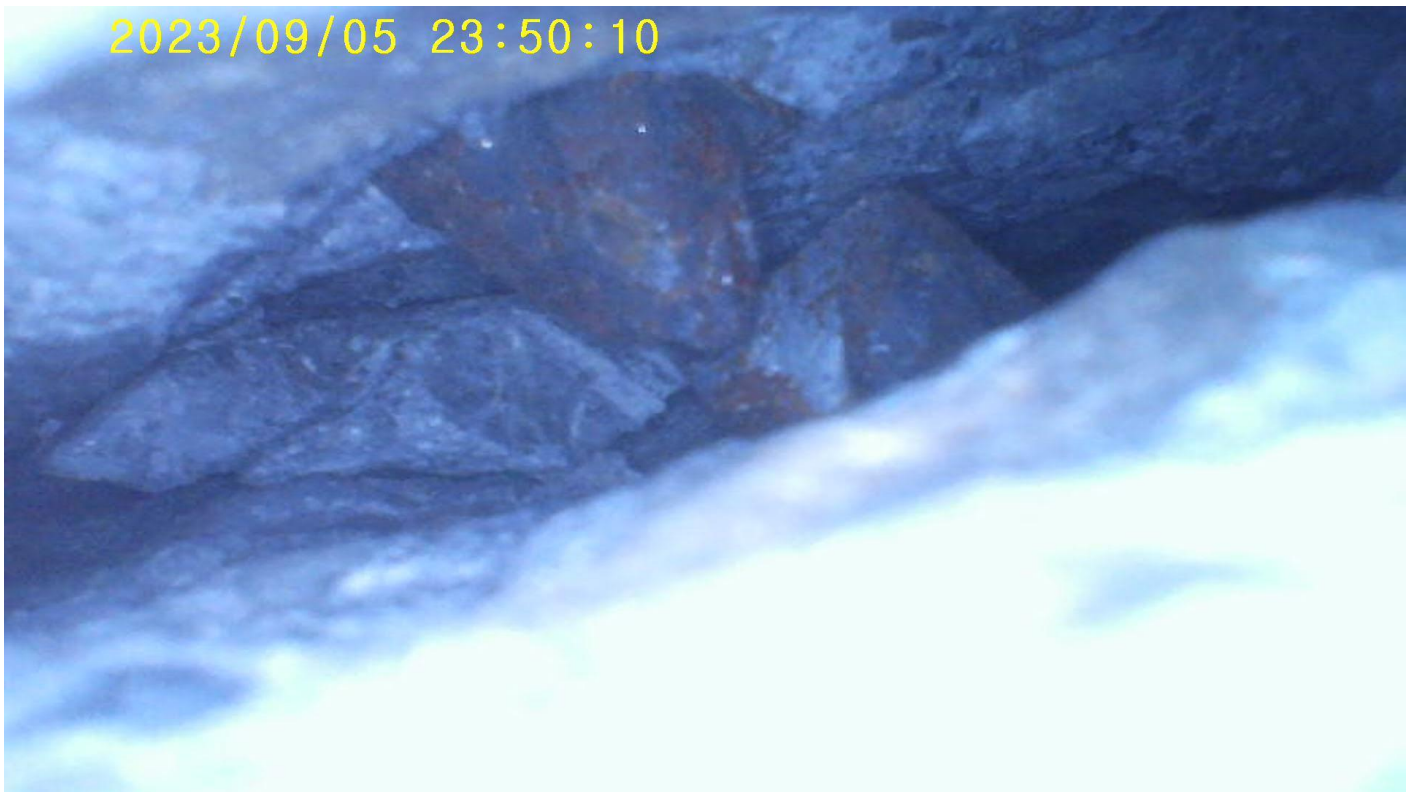
Figuur 3 Gebroken staaf in de breuk in ring 3297.
